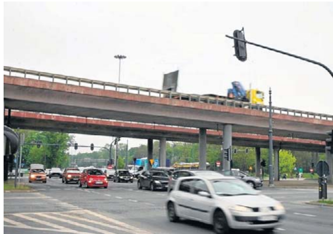
Prace na estakadzie rozpoczną się w czerwcu, gdy ruch w mieście robi się mniejszy. Remont na trwać pół roku
