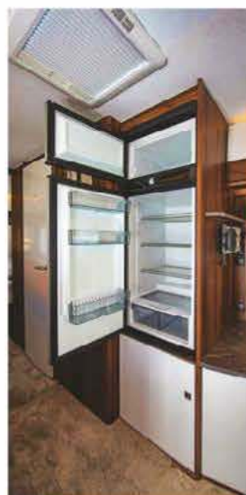
Lodówkę o pojemności 200 l ustawiono naprzeciwko aneksu kuchennego.
