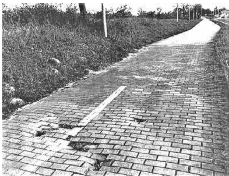
Jak widać na zdjęciu, w niektórych miejscach nastąpiła degradacja nawierzchni ścieżki rowerowej
