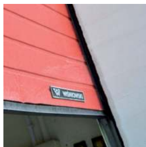
Uszkodzona brama garażowa
