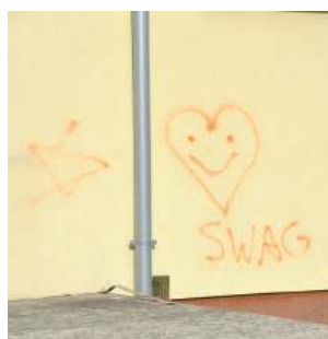
Zniszczona elewacja budynku remizy OSP w Łaziskach
