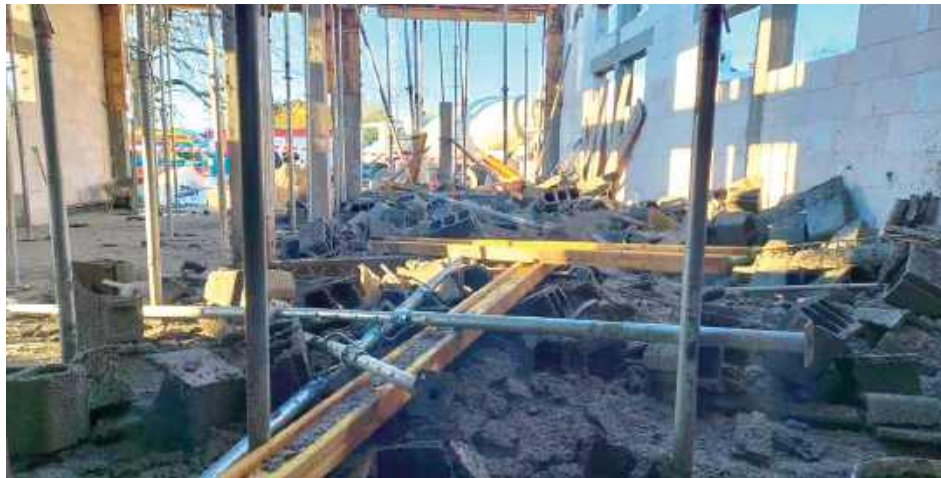
Na terenie nowo powstającego obiektu podczas zalewania betonowego stropu konstrukcja uległa zawaleniu. W wyniku zdarzenia obrażeń ciała doznało trzech mężczyzn w wieku 22, 43 i 64 lat – wszyscy to mieszkańcy Międzyrzecza Podlaskiego
