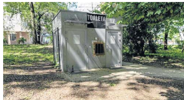
W szalecie na Plantach wandal zniszczył panel główny
