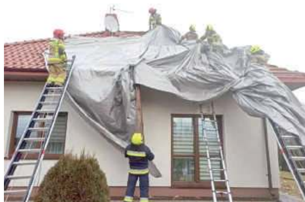
Burza spowodowała znaczne szkody w trzech budynkach mieszkalnych i jednym gospodarczym w miejscowości Sowin, gdzie uszkodzone zostały trzy dachy. Uszkodzony został również dach budynku mieszkalnego w Dębowej Kłodzie.
