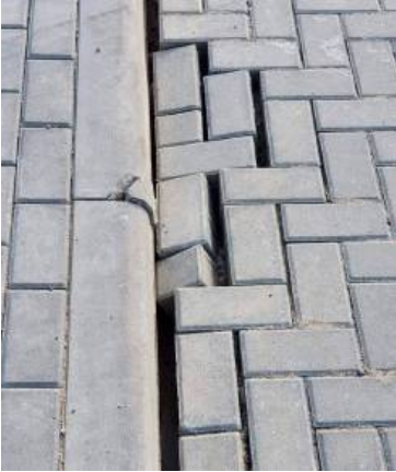
Nowo ułożona na ul. Czecha kostka w kilku miejscach zaczęła się rozjeżdżać
