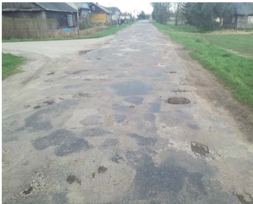
Stan drogi jest fatalny. - Zastanawiam się, czy dożyję gruntownego remontu. Nie wiemy już, z kim rozmawiać - denerwuje się nasz Czytelnik
