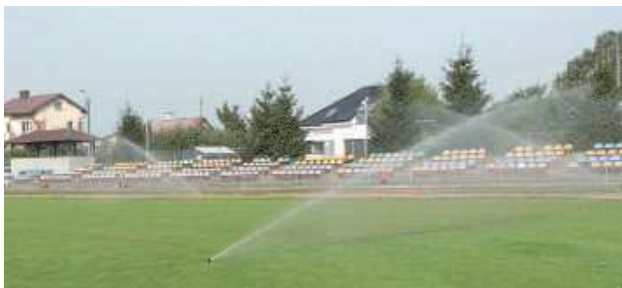
Na płycie boiska oraz w zakolach zainstalowane zostały 32 zraszacze
