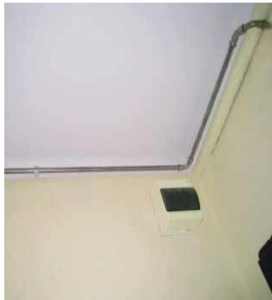
Rurka ciepłej wody w mieszkaniu
