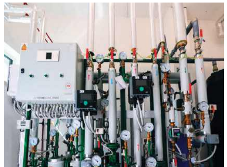
Węzeł ciepłowniczy, stąd rozprowadzana jest ciepła woda z budynków do poszczególnych mieszkań
