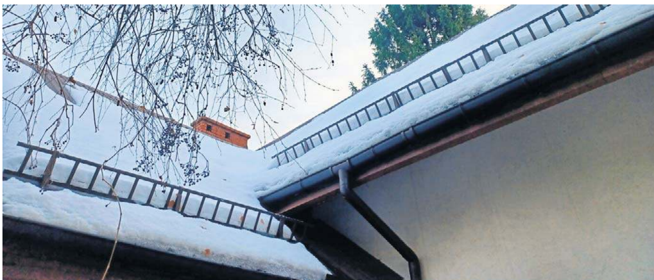
Barierzy przeciwśnieżne na dachu zapobiegają gwałtownemu zsuwaniu się mas śniegu z połaci.
