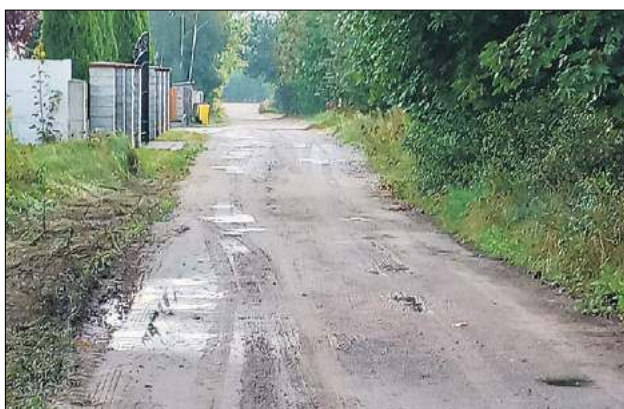
Budowa ul. Łowieckiej miała być projektowana już w 2019 roku, do dziś dokumenty nie zostały przygotowane. Tu nie ma nie tylko asfaltu, ale i oświetlenia
