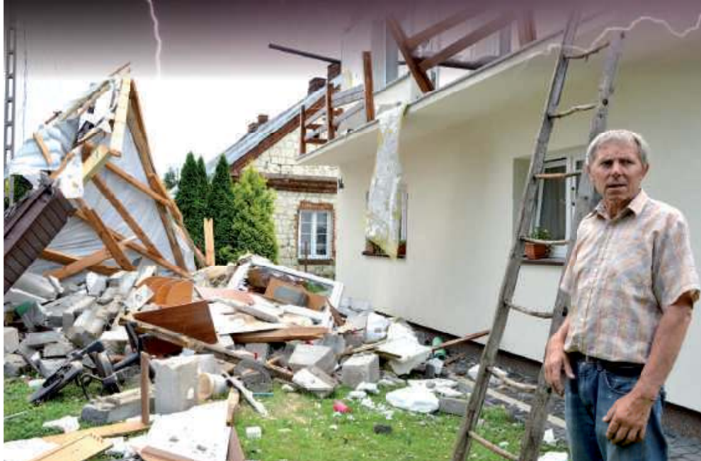
KOLONIA SZCZĘKARKÓW - Niedawno człowiek otrząsnął się po powodzi, a tu teraz jeszcze gorsze przyszło. Bo wtedy to dach nieuszkodzony był. Woda zesłała. Wszystko się posprzątało, a teraz w nocy jeszcze lało. Zalało stropy. Woda przesiąkała na dół. Podłogi już „popuchły” – mówi pan Henryk Giza, któremu wichura zerwała dach z domu
