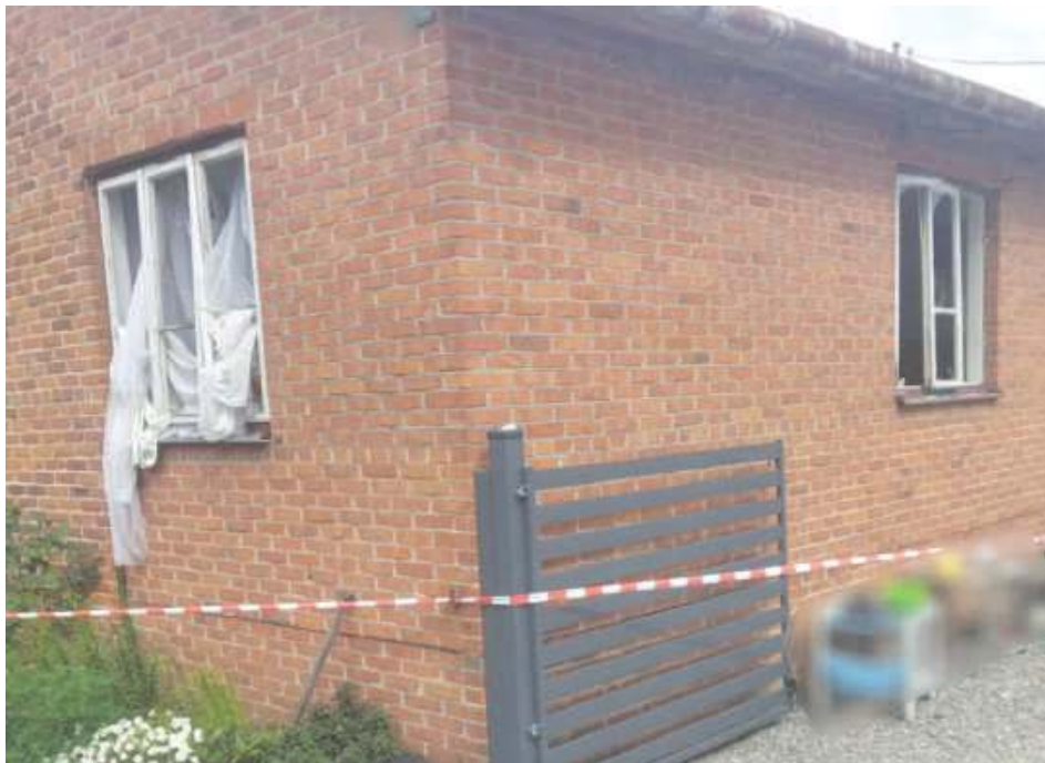
W wyniku wybuchu gazu uszkodzone zostały wszystkie okna i drzwi. Uszkodzona została również konstrukcja budynku. Popękaly ściany i poderwany został lekko strop
