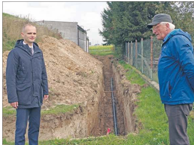
Priorytetem dla wójta Sylwestra Ziemkiewicza była modernizacja stacji uzdatniania wody w Radzanowie-Dębnikach
