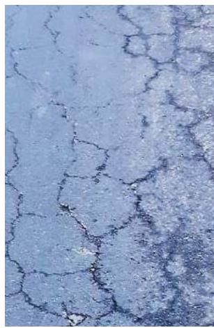
Takie spękania widać na drodze
