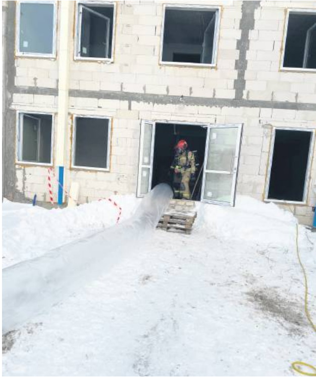
Specjalistycznymi antywybuchowymi wentylatorami odessano cały gaz, który uleciał z instalacji w piwnicy biurowca w Lipinie.
