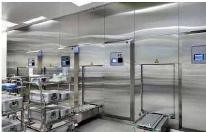
Fotografia 17. Wnętrze centralnej sterylizatorni w dużym szpitalu ( https://t.ly/8L1Mz )
