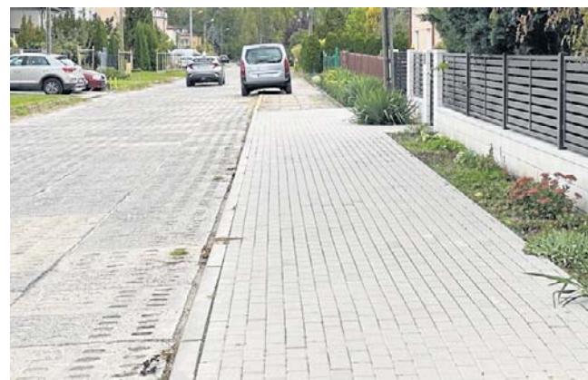
Ulica nie jest w najlepszym stanie - nie jest pokryta asfaltem, a betonowymi płytami. Dla straży miejskiej problemem stała się jednak zieleń, która zasadzili mieszkańcy.
