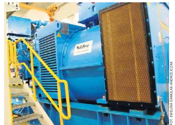
Elektrociepłownia na Piwonicach w Kaliszu ma nowe silniki kogeneracyjne.
