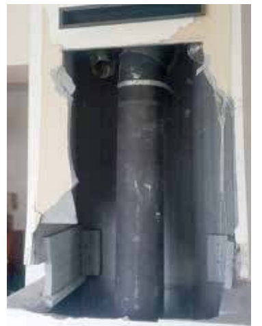
Felerny komin w trakcie akcji strażaków musiał zostać rozebrany
