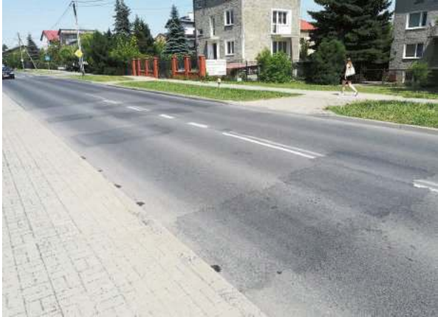
Choć od przebudowy ulicy Walecznych minęły zaledwie cztery lata jej nawierzchnia już wielokrotnie musiała być naprawiana i łataną
