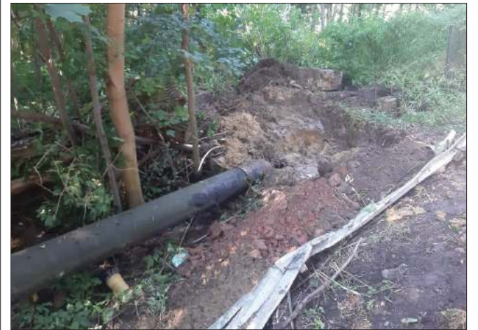
Rura została przerwana przy ulicy Dębowej w Skrzyszowie
