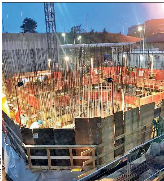
Oddanie do eksploatacji nowego bloku energetycznego oznaczać będzie poprawę efektywności energetycznej Koksowni oraz zapewni odbiorcom zewnętrzny dostawę ekologicznego ciepła systemowego i energii elektrycznej
