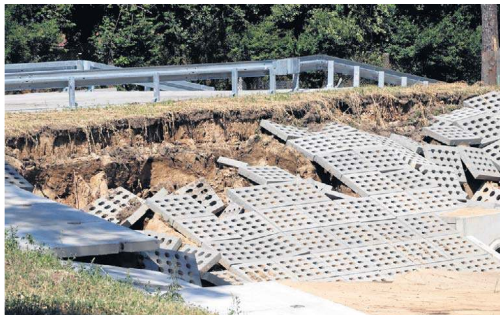
Woda spływająca kolektorem podmyła płyty nowego zbiornika retencyjnego
