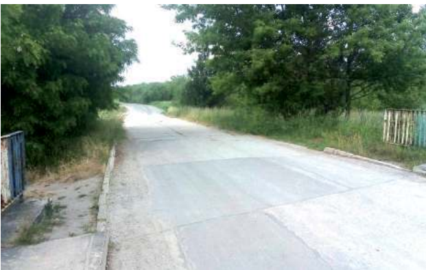
Stan drogi od dziesięcioleci jest opłakany. Jest to odcinek niespełna kilometrowy, ale ważny ze względu na skrót i dojazd mieszkańców do cmentarza parafialnego
