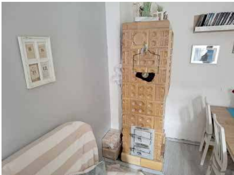
Chwiejąca się podłoga była przyczyną tego, że pewnego dnia drzewo składowane przy piecu spadło na syna mieszkanki. Chłopiec odskoczył w ostatnim momencie
