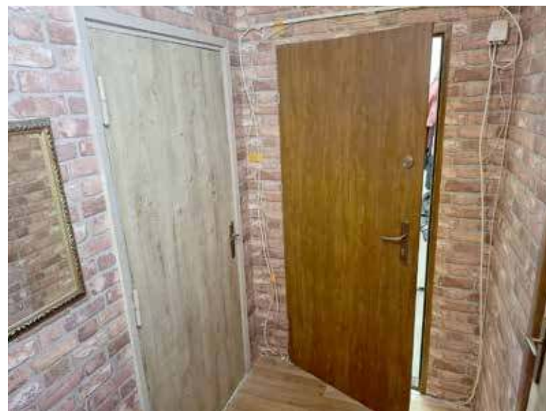
Drzwi są zamontowane kolizyjnie względem siebie, co powoduje, że osoba wychodząca z mieszkania, musi bardzo uważać, by nie uderzyć sąsiada
