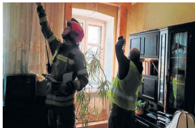
Oględziny wnętrza w częściowo zawalonej kamienicy przy ulicy Wólczańskiej
