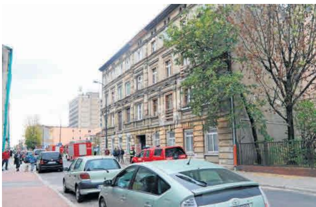
Zawalił się strop kamienicy przy ulicy Wólczańskiej 43, a następnie zaczęły pękać jej ściany
