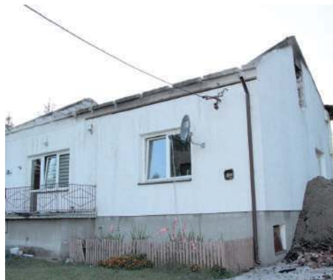
Ogień zdążył pochłonąć część dobytku. Spłonął dach, strych, część mieszkalna domu została zalana wodą podczas gaszenia pożaru
