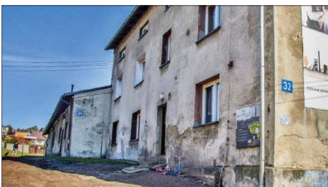
Budynek przy ul. Hallera w Radlinie zostanie wyremontowany. Na czas remontu jego mieszkańcy trafią do kontenerów. Po remoncie do budynku wrócą tylko ci, którzy uregulują zadłużenie.
