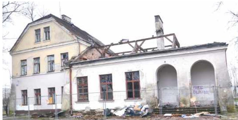
Proces niszczenia dworca w Leopoldowie znacznie przyspieszył na skutek zdjęcia połowy dachu
