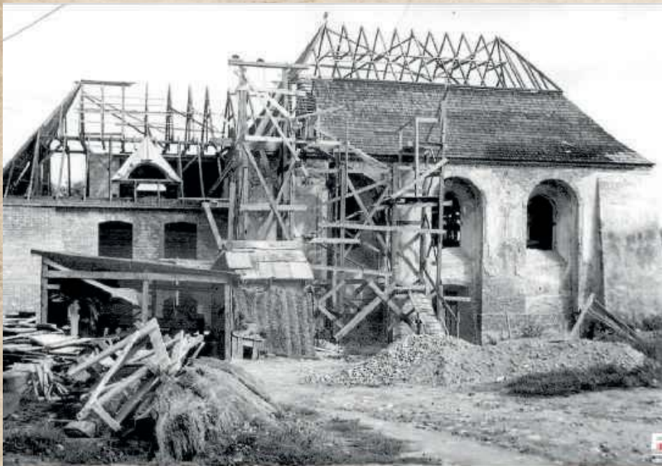
Duża Synagoga w Łęcznej. Zbudowany w XVII wieku budynek w XIX stuleciu dwa razy padał ofiarą pożarów. W czasie II wojny światowej zupełnie zdevastowany przez Niemców. W 1952, wobec pogarszającego się stanu technicznego i notorycznego rozkradania, postanowiono o rozbiorce, ale nawet na nią zabrakło pieniędzy, zaczęto więc remont, który potrwał 12 lat. W jego trakcie w miejsce oryginalnego babińca (z lewej) zbudowano zupełnie nowy.
