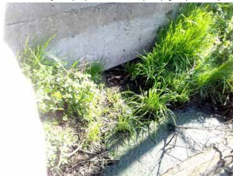
Kontrolujący zakład pracownicy gminy zaobserwowali odcieki ze składowiska na przylegające tereny
