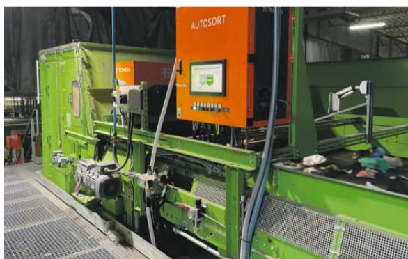
Sortownia odpadów komunalnych w ZUT Gdańsk
