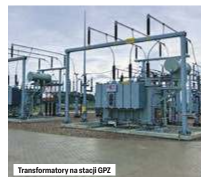
Transformatory na stacji GPZ
