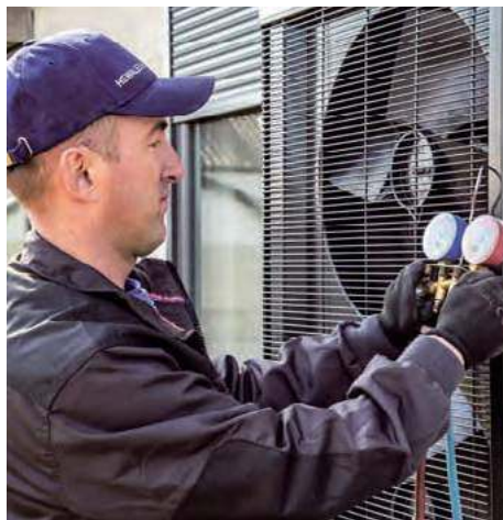
Przeglądy okresowe pomp ciepła są wymagane przez producentów szczególnie w okresie trwania gwarancji. Dzięki systemowi EKONTROL-DIAGNOSTYKA, pompy ciepła Hewalex PCCO wymagają przeglądów w razie występowania ewentualnych nieprawidłowości w pracy.
