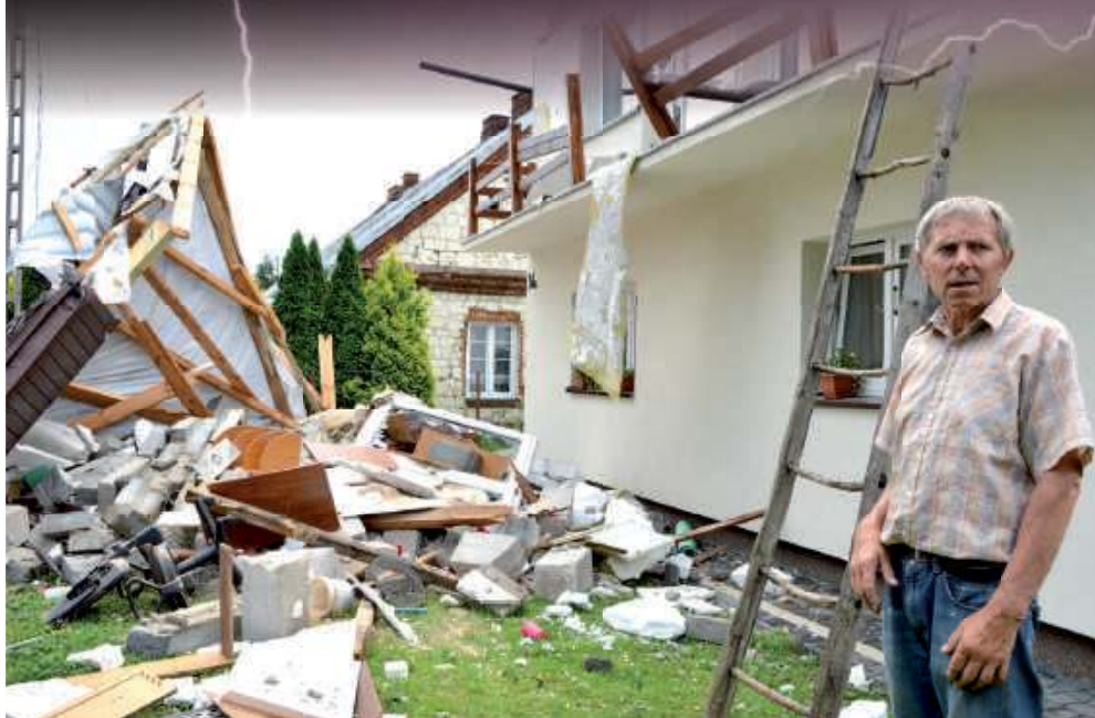
KOLONIA SZCZĘKARKÓW - Niedawno człowiek otrzaskał się po powodzi, a tu teraz jeszcze gorsze przyszło. Bo wtedy to dach nieuszkodzony był. Woda zesłała. Wszystko się posprzątało, a teraz w nocy jeszcze lało. Zalało stropy. Woda przesiąkała na dół. Podłogi już „popuchły” – mówi pan Henryk Giza, któremu wichura zerwała dach z domu
