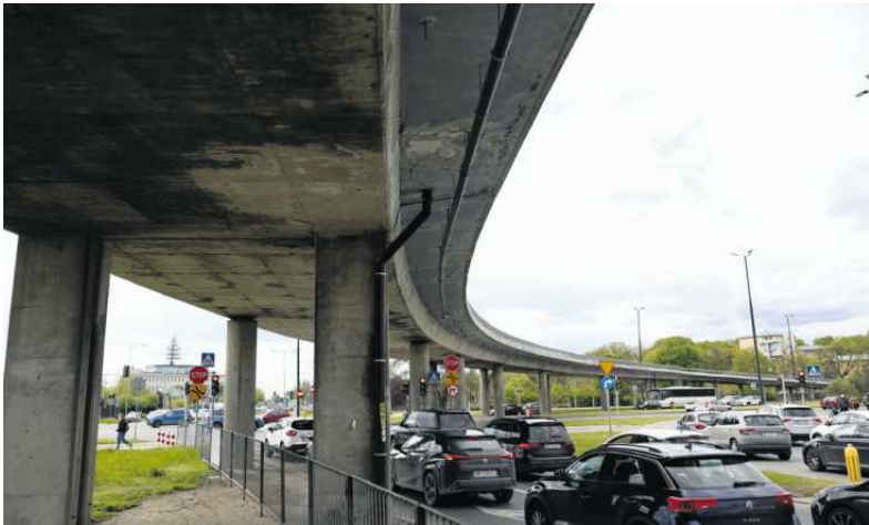
• Wiadukt przeznaczony do rozbiórki FOT. MACIEK JAŻWIECKI / AGENCJA WYBORCZA.PL
