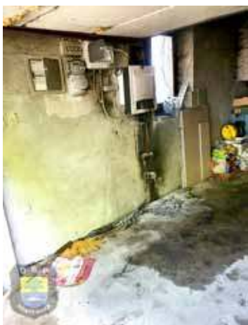
W miejscowości Kolin strażacy z Kobylanki gasili pożar instalacji fotowoltaicznej. Foto. OSP Kobylanka
