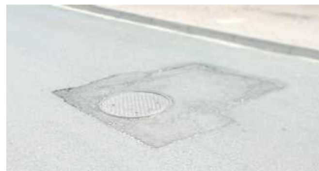
Asfaltowe łaty pękają i nawierzchnia jest nierówna
