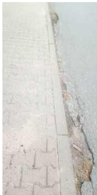
Przy krawężnikach są nadżerki
