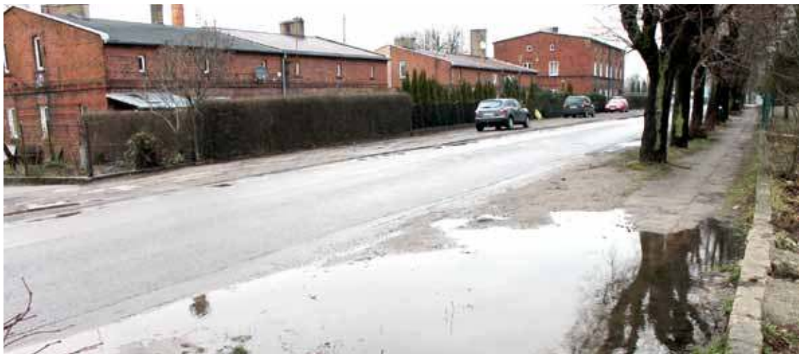
Stan chodnika przy ul. Głównej. Foto ze stycznia 2019. Niestety, dzisiaj w nie lepszym stanie
