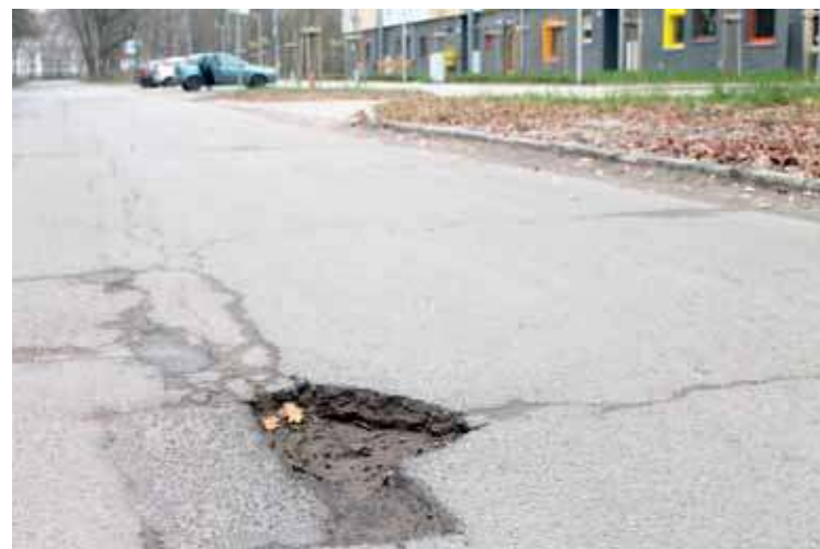
Ul. Śniadeckiego, kilka metrów dalej i kolejna głęboka dziura w jezdni
