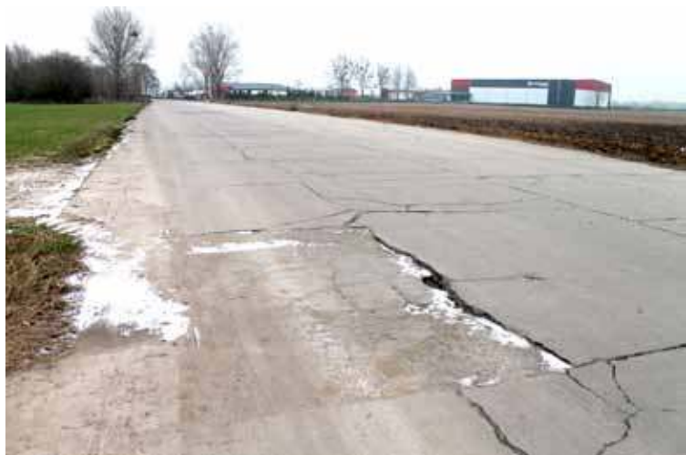
Opisywana już w piątek wielka dziura na Śniadeckiego jest dość głęboka a zauważalna dla samochodu staje się dopiero, gdy pojazd jest tuż przy niej. Widok od Os. Lotnisko
