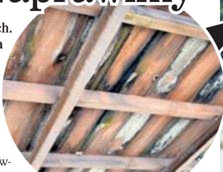
Między deskami są niewielkie szpary i to przez nie zapewne cieknie woda.
