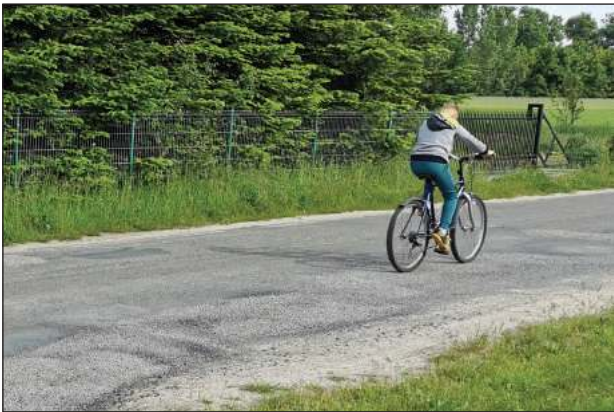
» Jakiś czas temu na ulicy Spacerowej w Leopoldowie był kładziony asfalt. Modernizacja objęła tylko część drogi. Pozostały odcinek dalej pozostawał w złym stanie
