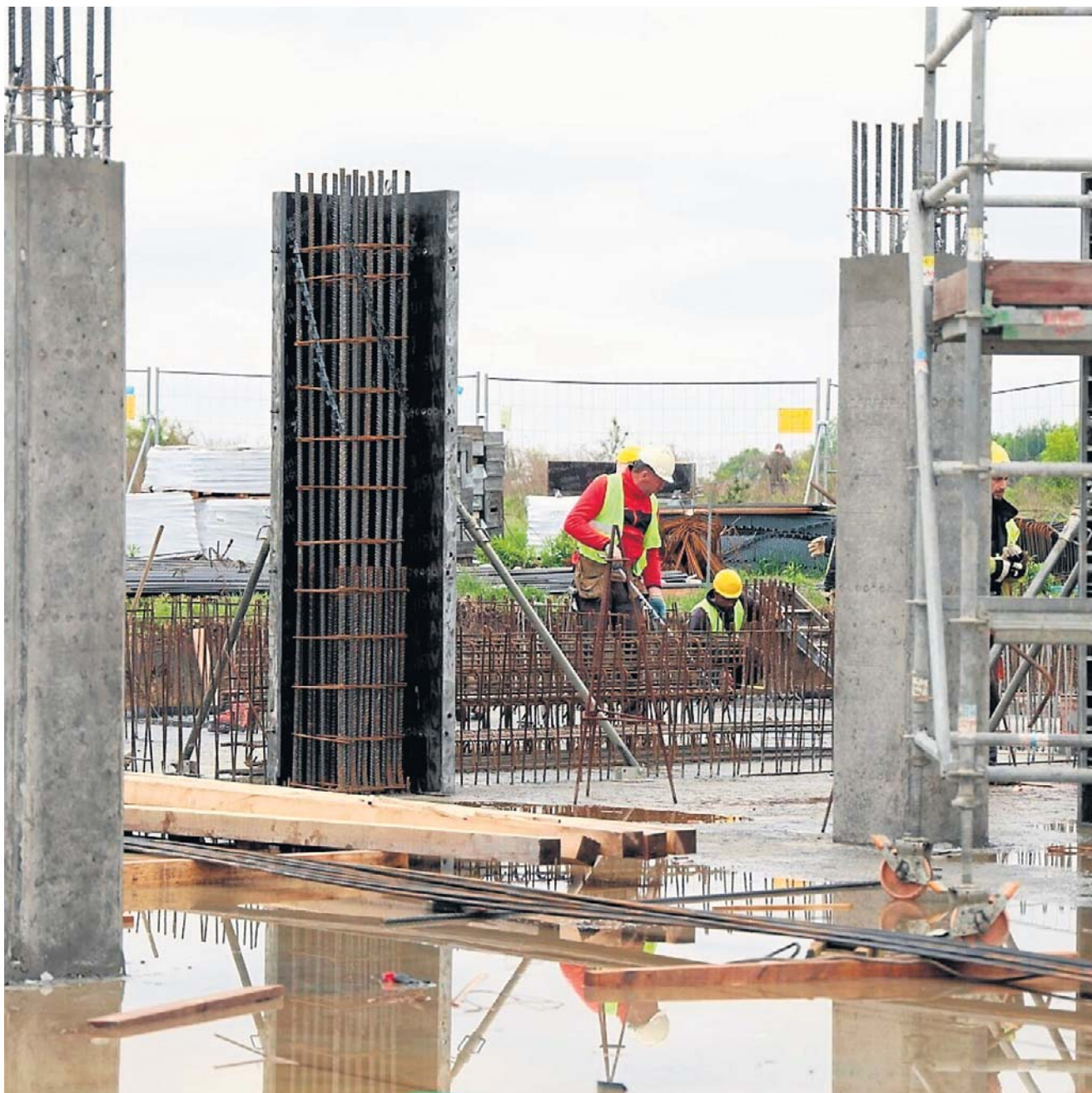
Przy ul. Bazylkowej w Kaliszu wmurowano akt erekcyjny, oficjalnie inaugurując budowę zespołu budynków mieszkalnych wielorodzinnych. Trwa budowa.
