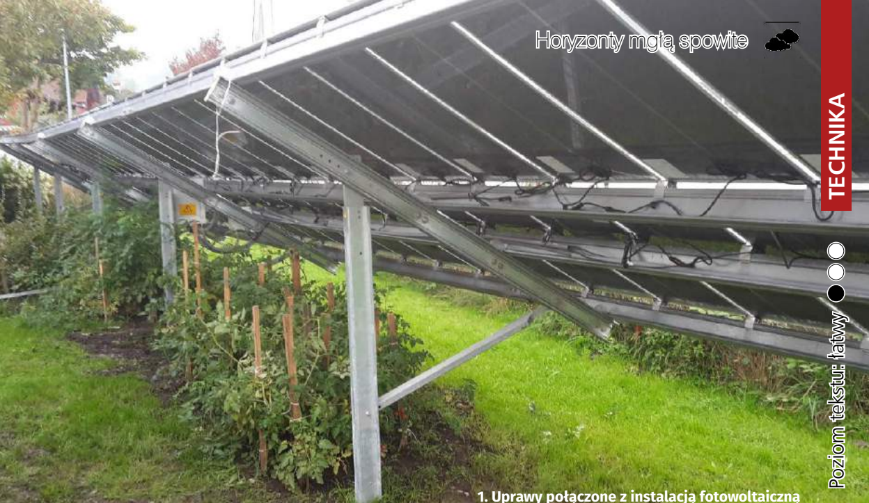
1. Uprawy połączone z instalacją fotowoltaiczną
