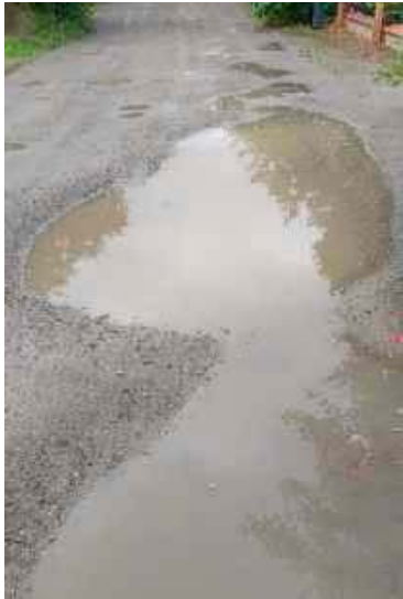
Usiana dziurami ulica Deotymy na razie zostanie doraźnie naprawiona. Na budowę będzie musiała jeszcze poczekać
