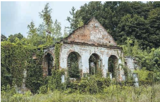
Elewacja frontowa pałacu pozbawiona tynku oraz elementów architektonicznych i zdobień
