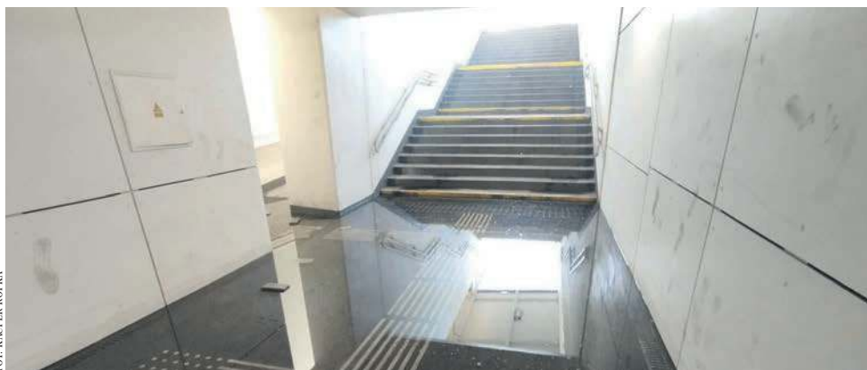
Przejście podziemne na ul. Zagrody w Krzeszowicach notorycznie zalane jest wodą
