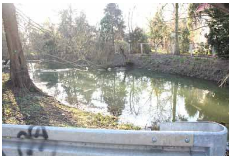
Podwyższony poziom wody jest widoczny gołym okiem
